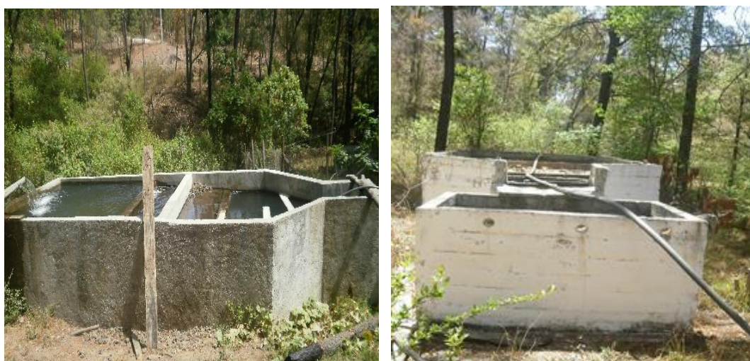
Figura 43. Filtro desarenador al interior de las granjas de trucha, municipio de Morelia.
