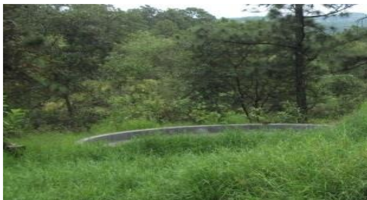
Figura 39. Estanque inactivo por mala planeación en la construcción, Mpio de Morelia
