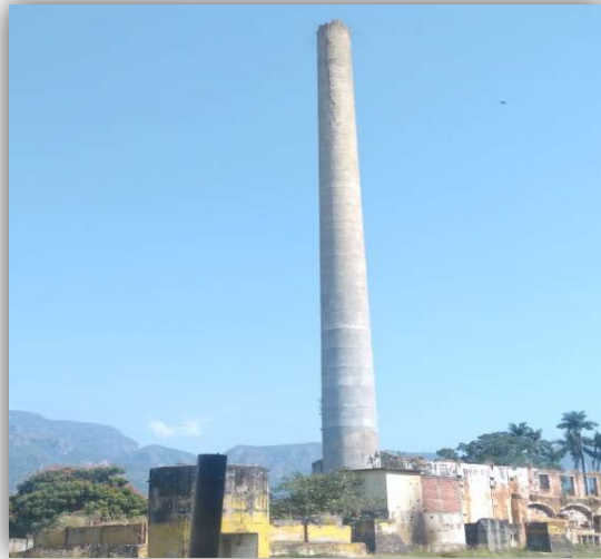
Imagen 35. La punta del chacuaco sufrió daños con el sismo del 19 de septiembre de 2017
