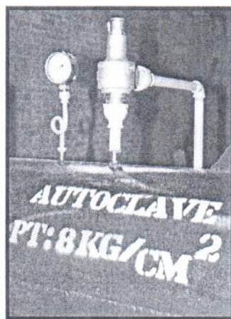
Figura 43. Válvula de seguridad y manovacúometro.
