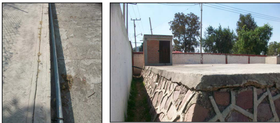
Fotografía 7 Depósito de almacenamiento para el agua del pozo del Molino de Flores
