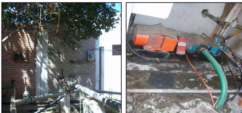
Fotografía 6 Sistema de bombeo Temiche
