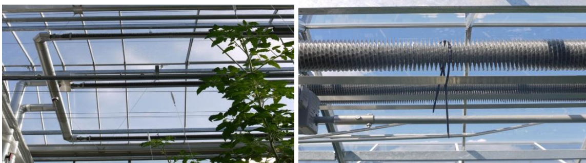
Figura 5. Tubos corrugados de aluminio colocados bajo el techo del invernadero.
