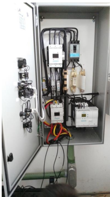
Figura 12 Arrancador tipo para pozo de riego.
