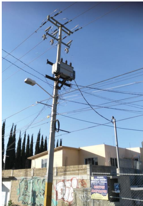
Figura 14. Transformador trifásico tipo poste.
