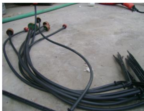
Figura 7. Gotero con tubing y estaca.
