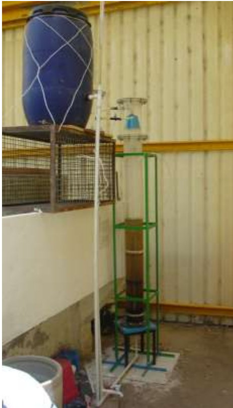
Tambo de suministro de agua residual
