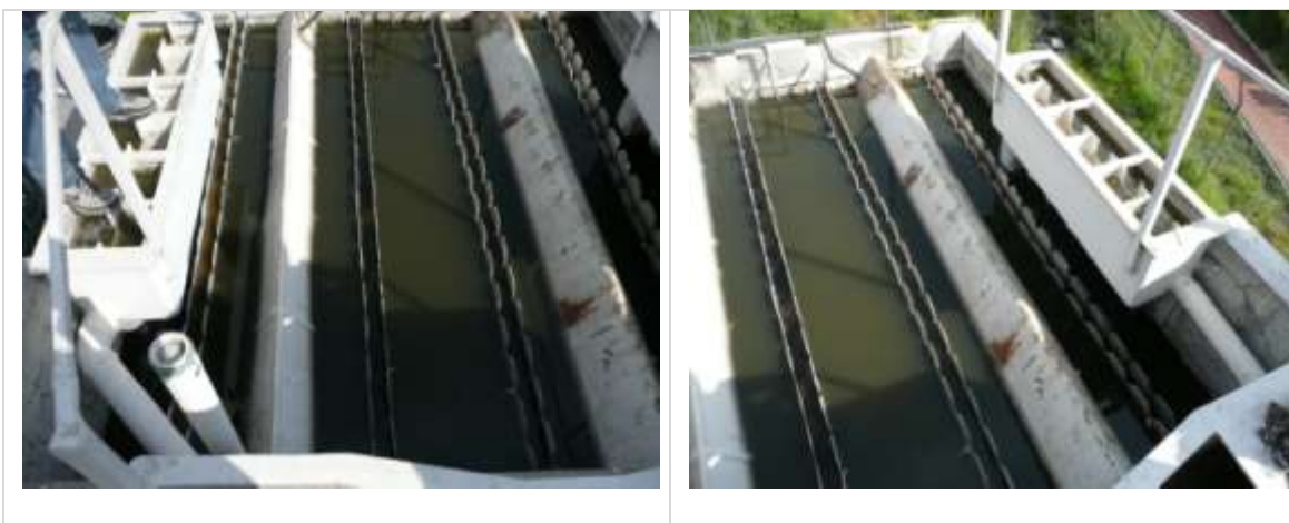
Figura 8.3 Reactor a escala piloto en las instalaciones de la UAM
