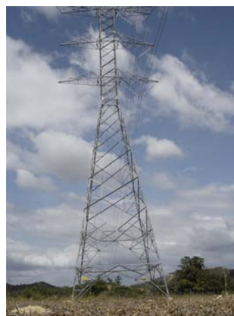
Generación energía eléctrica La Angostura
