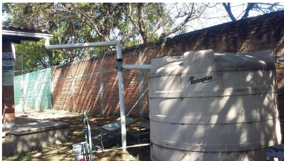
Figura 25. Sistema de captación de agua de lluvia en huerto escolar.
