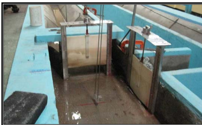
Figura 10. Compuertas rectangulares deslizantes instaladas en represas y tomas.
