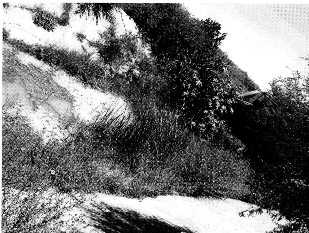
Foto 18. Canal principal invadido de vegetación.
