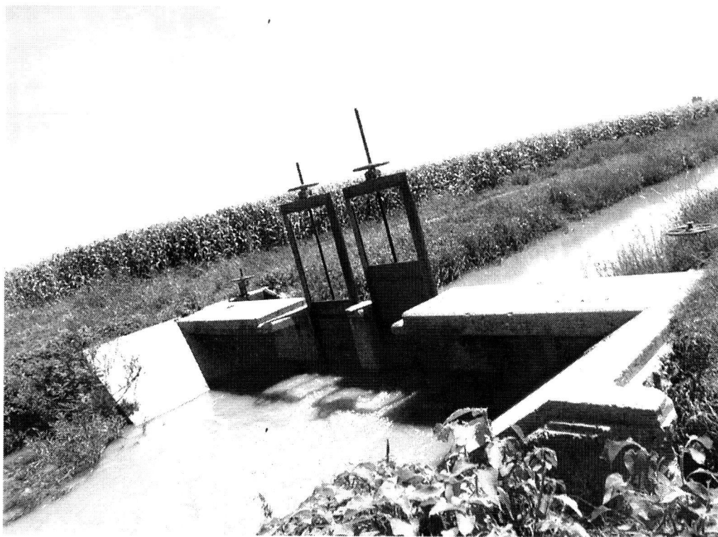
Foto 19. Compuertas en canal secundario.
