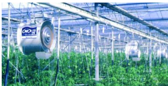
Figura 7. Ventiladores para recirculación de aire Fuente: Teyme Aircool-Teyme
