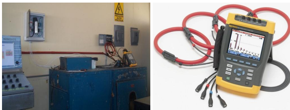
Figura 15. Medición de los parámetros eléctricos con el FLUKE 450
