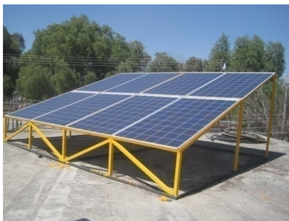
Figura 42. Arreglo fotovoltaico de ocho módulos fotovoltaicos
