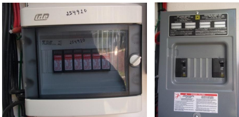
Figura 49. Conexiones del sistema de conducción y seguridad
