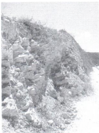
Condición general del talud en el sitios 1
