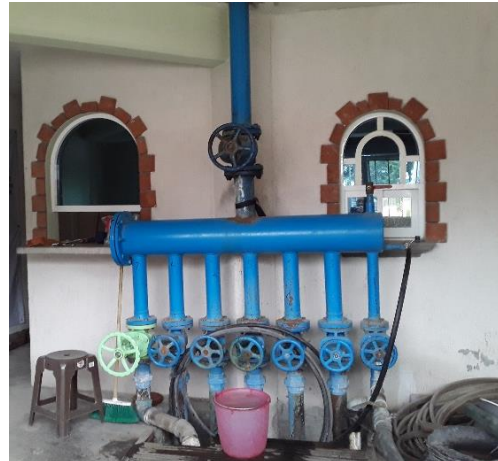
Ilustración 28 Foto de las válvulas de agua
