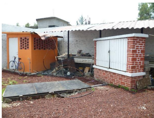
Figura 2. Pozo y Bomba de extracción
