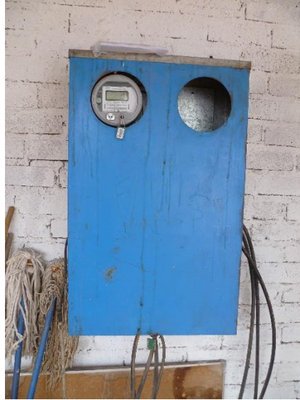
Figura 3. Medidor de Energía.
