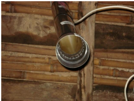
a. Vista luminoducto-difusor interior de la bodega agropecuaria
