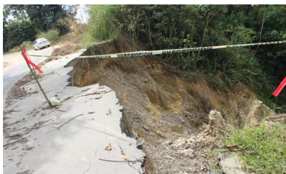
Figura 49. Afectaciones en la carretera de Pluma Hidalgo
