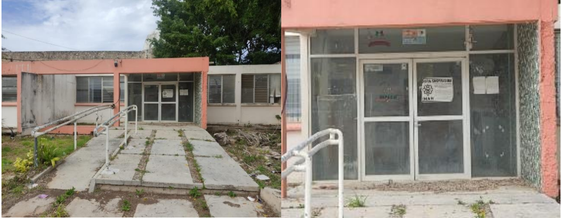
Ilustración 4: Imágenes de la antigua clínica de salud del municipio
