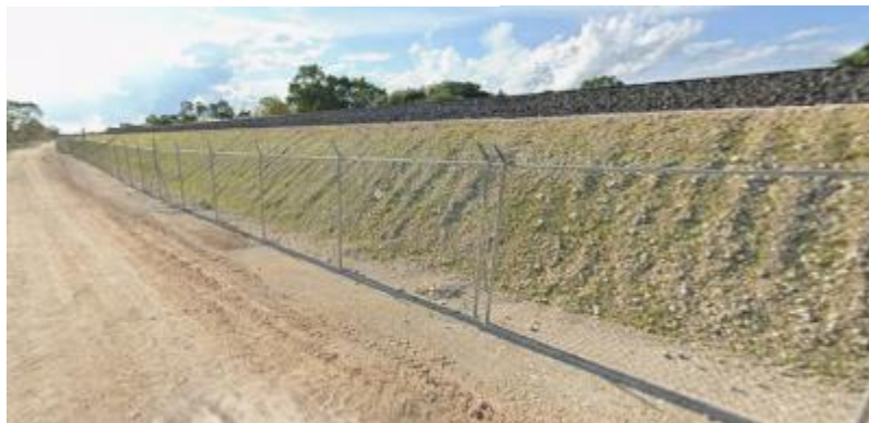
Figura 18: Perímetro enmallado en las vías
