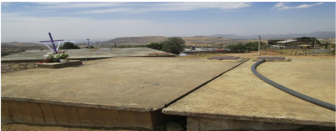
Figura 27. Depósitos Cuahutenco. En la imagen se observa tres depósitos. Primero fue construido el de la derecha (hace 50 años aproximadamente), después el de la izquierda (hace 30 años aproximadamente) y por último, el del fondo ubicado en la parte más baja, abastecido con una parte del agua del manantial Atexcac (hace 12 años aproximadamente).
