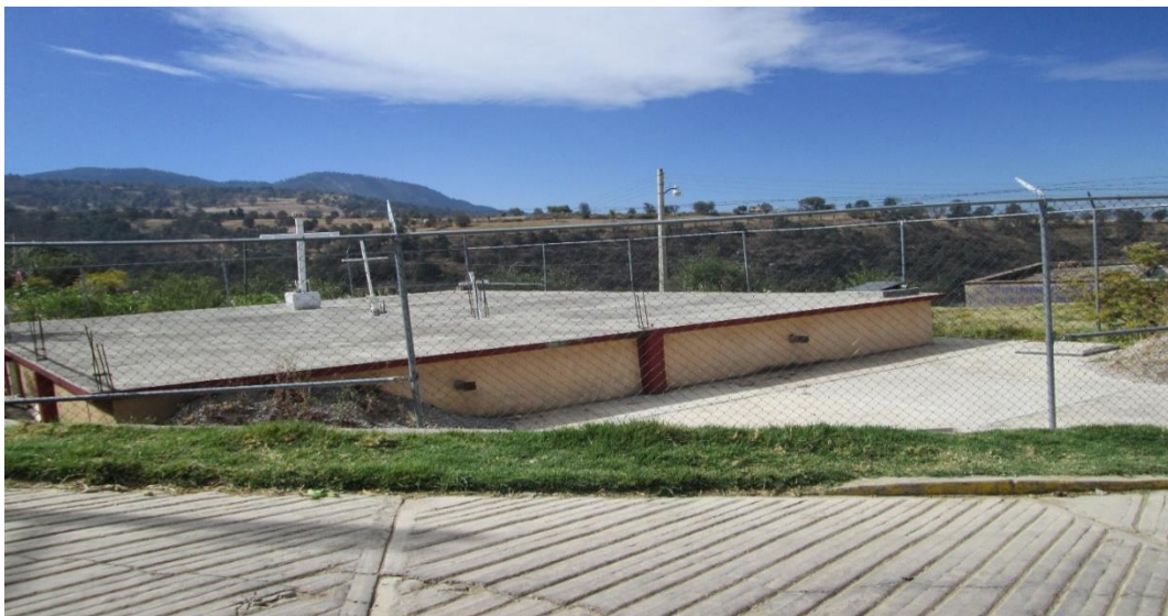
Figura 18. Depósito de agua potable Coloxtitla, alimentado por el manantial Atlmeya. Este depósito tiene una dimensión aproximada de 10 x 10 metros de base x tres de profundidad.
