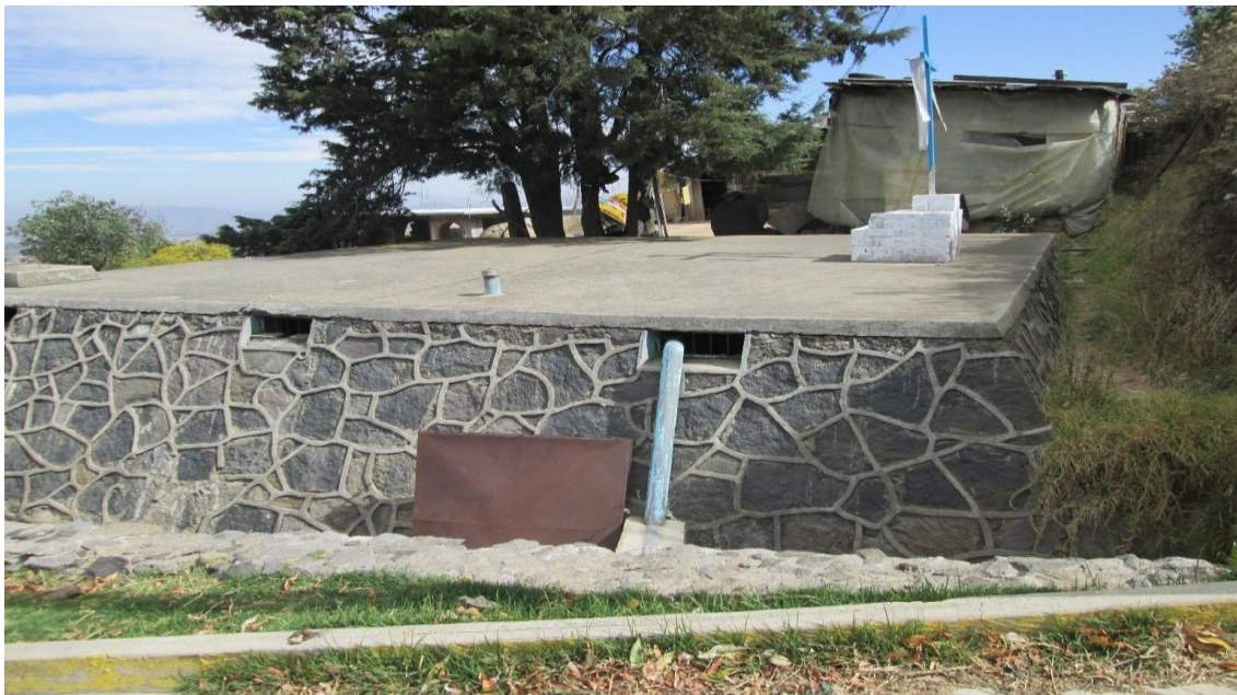
Figura 17. Depósito Cuamanco, alimentado por el manantial Tecamalacachifia. Este depósito tiene una dimensión aproximada de 8 x 8 metros de base x 3 de altura.
