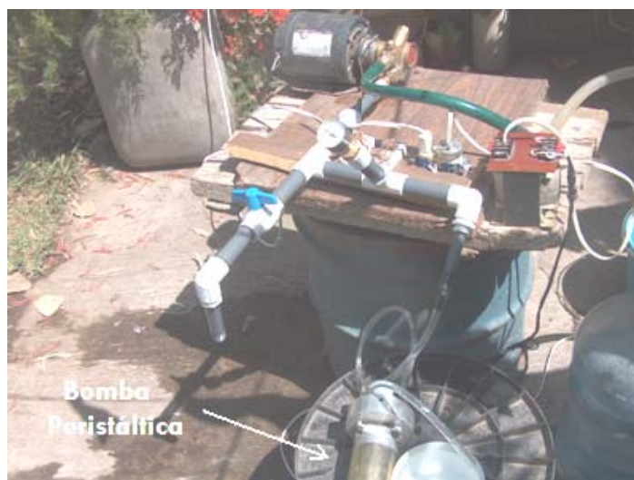
Figura 3.11 Sistema para suministrar y controlar la presión del agua en la tubería de la bomba peristáltica.
