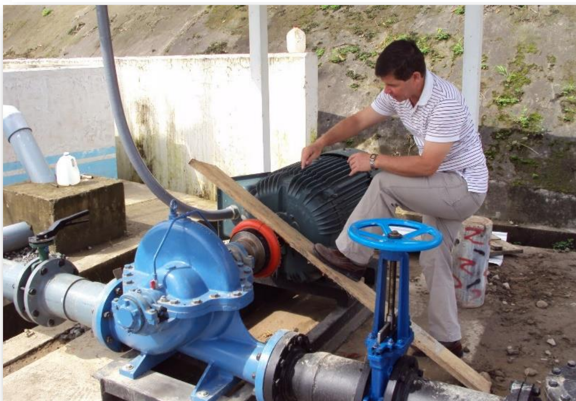
Fotografía 18 Equipo de bombeo
