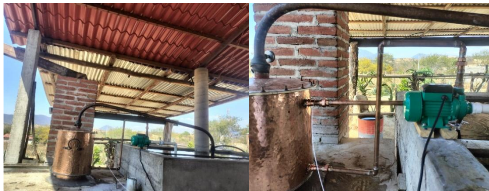
Figura 15. Instalación del sistema de control.
