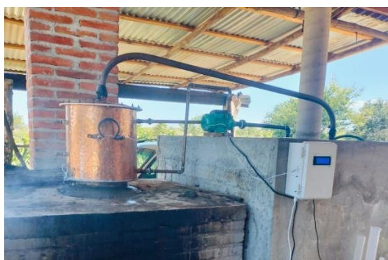
Figura 16. Gabinete de control.
