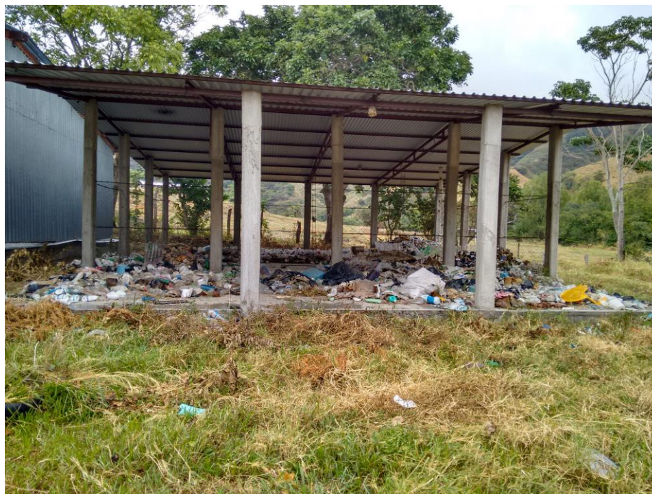
Foto 2. Centro de acopio comunitario abandonado.
