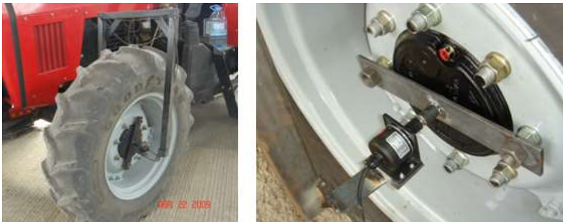
Figura 6.11 Acoplamiento del encoder y alineación con el eje de la rueda delantera.
