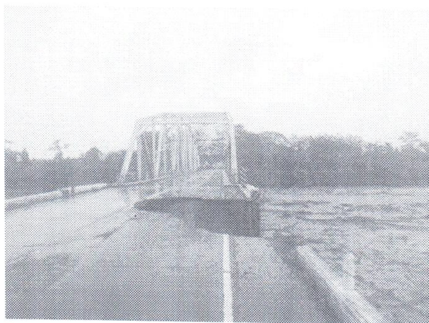
Figura 4. Puente en Chiapas dañado por deslave de las fuertes corrientes de agua
