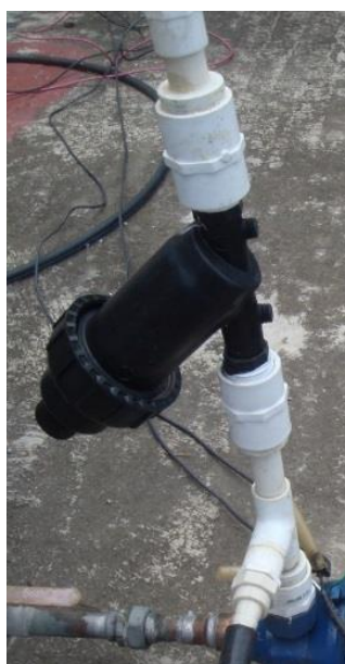
Figura 25. Filtro en línea del sistema nebulizador. Fuente: Autor, 2015.
