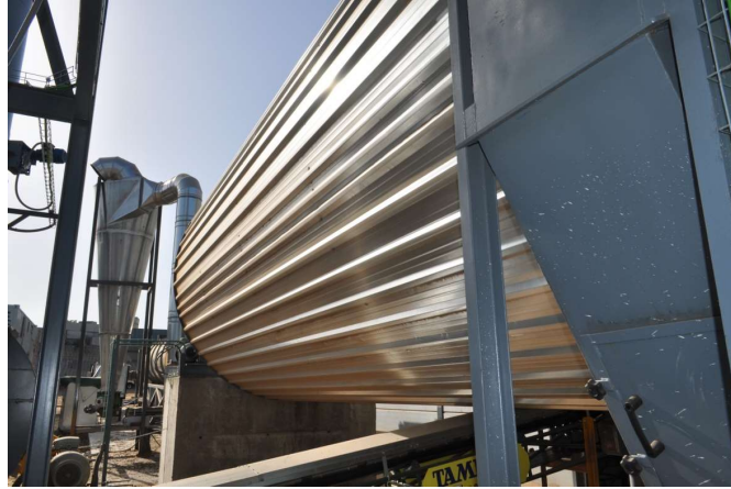
Figura 24. Secador de astilla tipo trommel, que funciona por medio de una caldera de biomasa.
