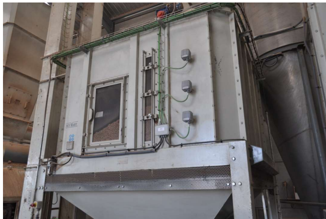
Figura 29. Cámara de enfriamiento del pellet.
