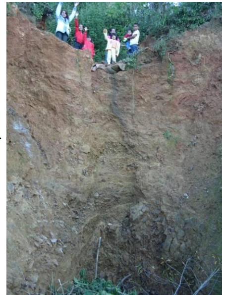
Hundimientos, barrio El Mirador.
