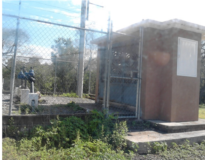
Figura 9.22. Pozo y red de agua potable de la comunidad El Platanal.
