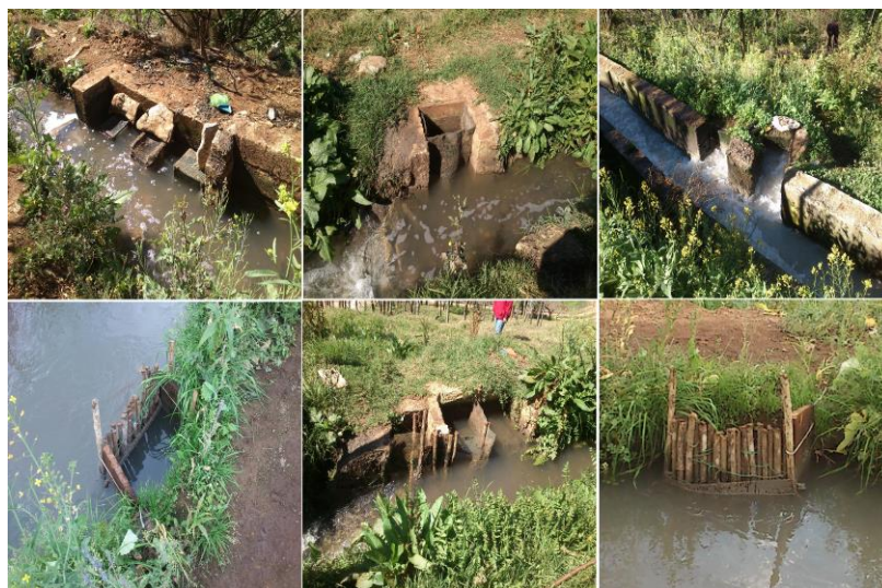
Fotografía 7. Distribuidores y coladeras.
