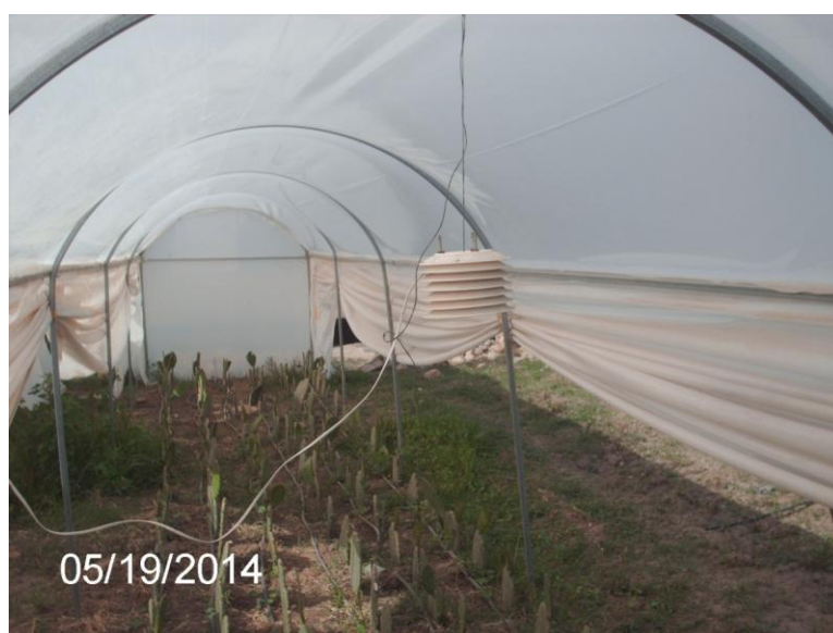
Figura 15 Instalación de los sensores de temperatura del aire y humedad relativa HMZ433A1 dentro de un microtúnel.
