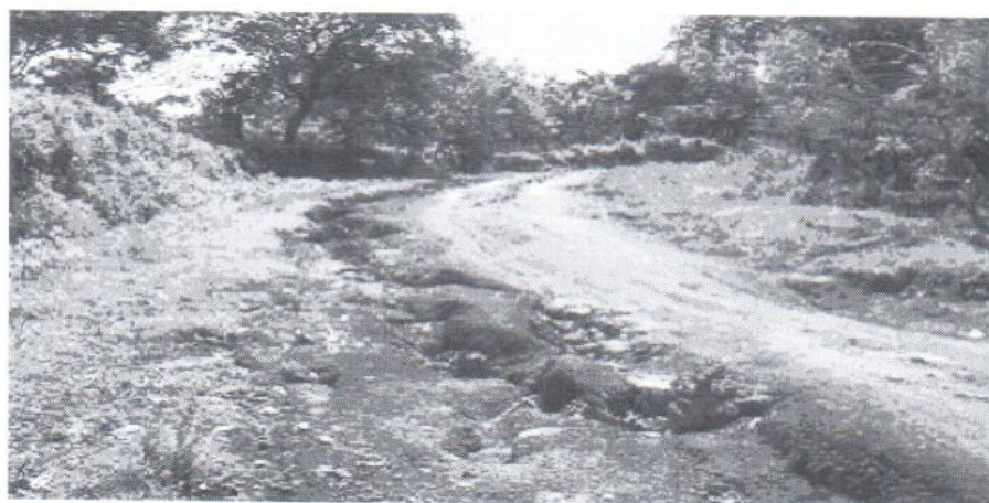
Figura 17. Camino construido con una mala planeación.
