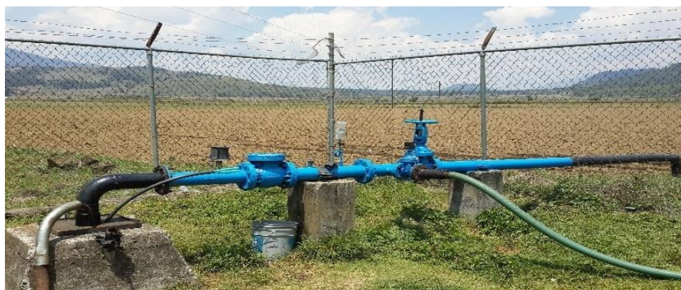
Figura 13. Sistema de bombeo del pozo profundo, San Miguel Pomacuarán. Tomada: Diana Fuerte.
