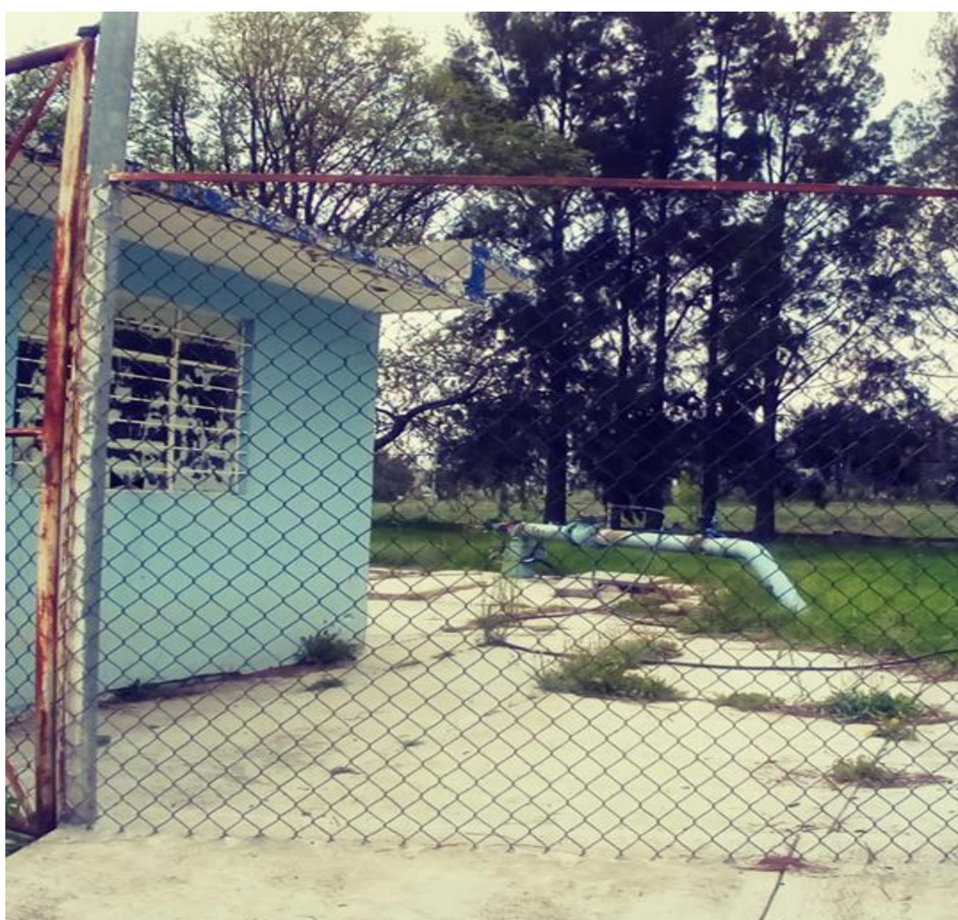
Figura 6 Pozo que abastece a la comunidad. Fuente: Trabajo de campo, 2018
